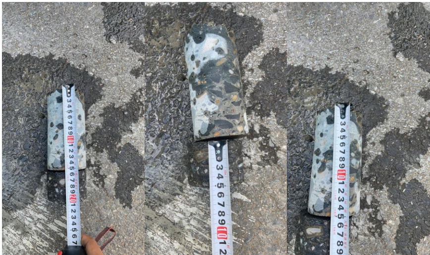
马洼线（取芯完整，面层沥青厚度约为 6cm，水泥板厚度约为 15cm）
