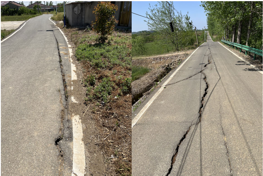
横向裂缝、纵向裂缝，塌陷
