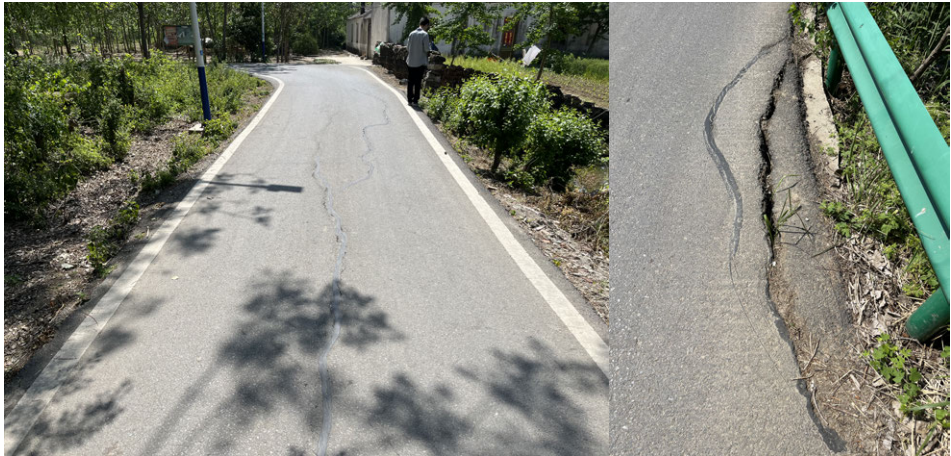
纵向、横向裂缝、板角断裂、修补 徐李线沥青路面损坏调查及统计表
