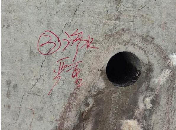
(a) 13#块右箱室腹板开孔后箱内有积水排出
