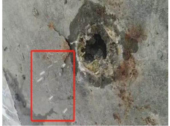
(c) 11#块左箱室底板泄水孔疏通后箱内有积水排出
