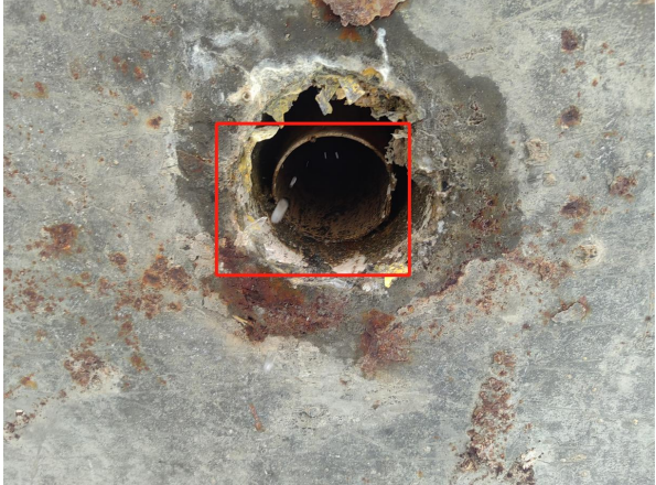
(b) 13#块右箱室底板泄水孔疏通后箱内有积水排出
