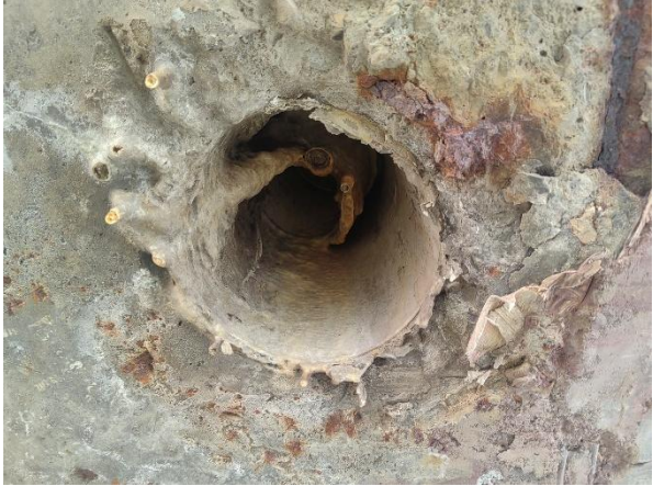
(d) 13#块左箱室底板泄水孔渗水
