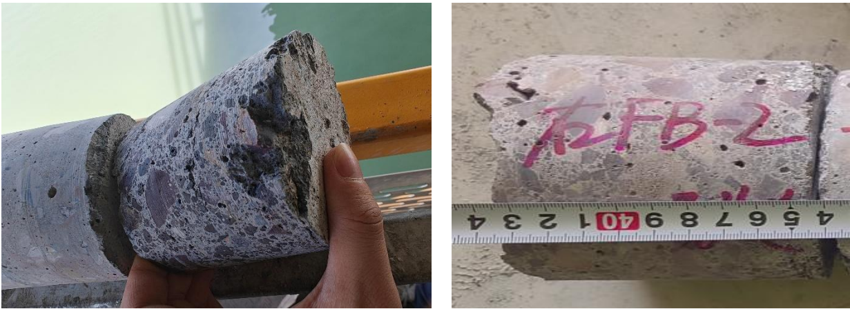
(c) 13#块左箱室铁砂混凝土较为密实 (d) 11#块右箱室铁砂混凝土密实 图 1.2-12 3#孔压重段芯样外观检查结果
