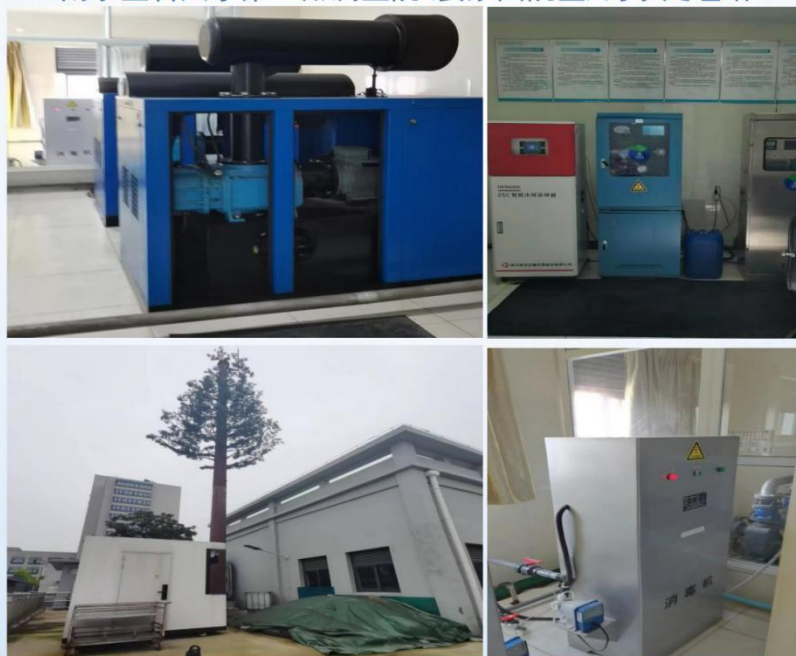
南京市高淳区人民医院污水处理站
