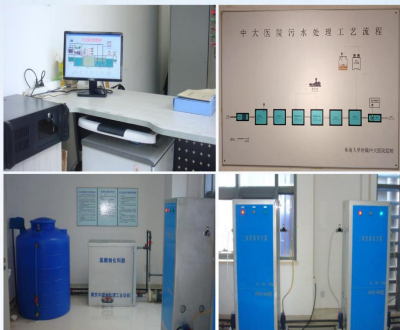
东南大学附属中大医院污水处理站
