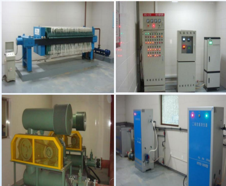
南京鼓楼医院南扩项目污水处理站
