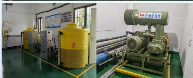
宿迁第一人民医院污水处理站
