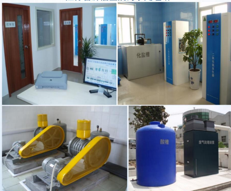
南京医科大学附属江宁医院污水处理站
