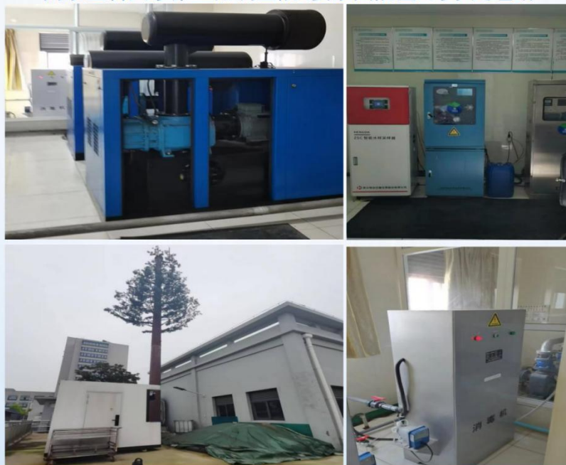
南京市高淳区人民医院污水处理站
