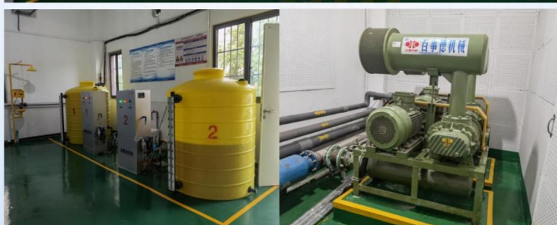
宿迁第一人民医院污水处理站
