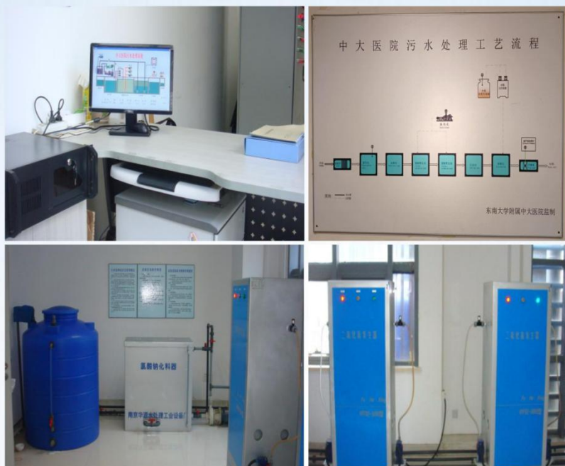
东南大学附属中大医院污水处理站
