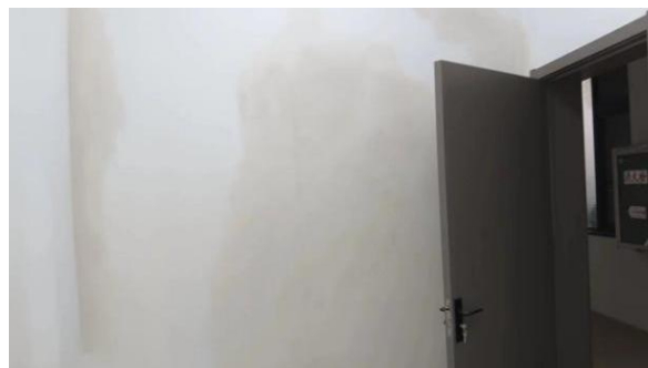
一楼伸缩缝墙面渗漏
