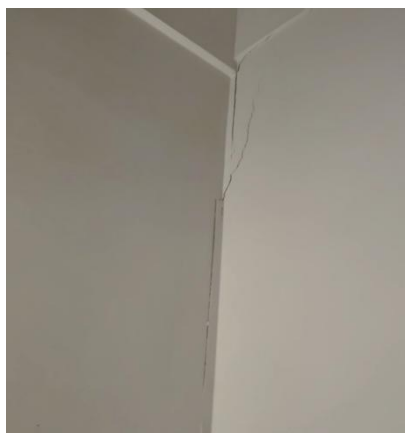
南侧房间墙角开裂
