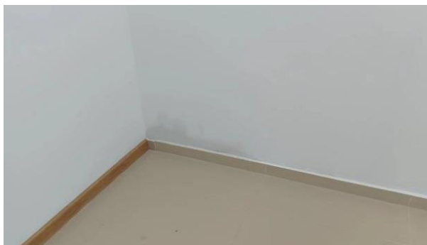
一楼东侧方面墙面渗漏
