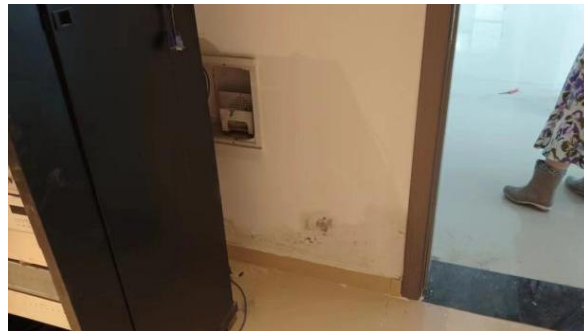
一楼北侧机房墙角渗
