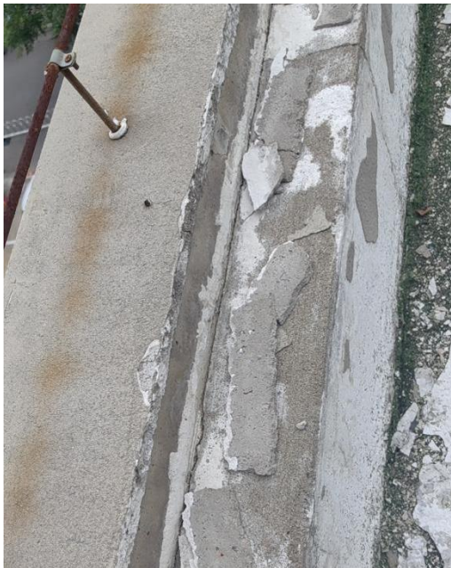
楼顶女儿墙出现裂缝
