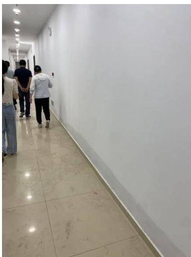
北侧走廊墙面渗水
