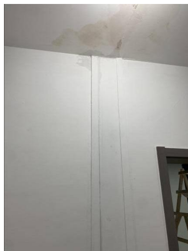
北侧伸缩缝渗水
