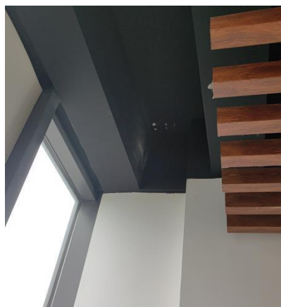
南侧房间吊顶渗水
