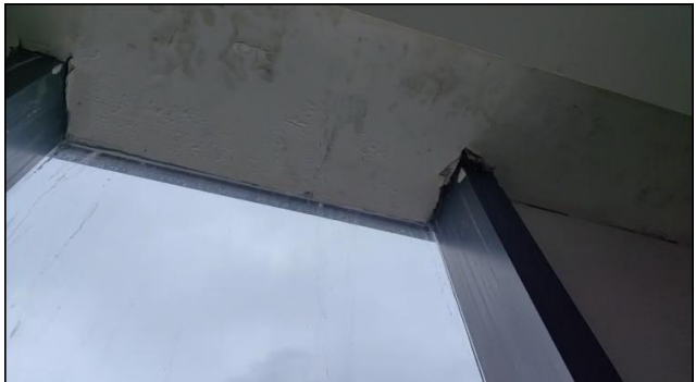
西南侧房间顶部渗漏
