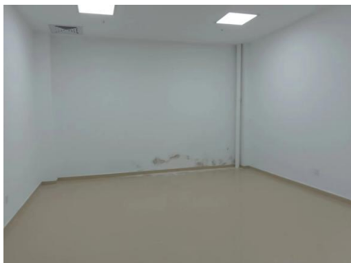
东侧房间墙面渗水
