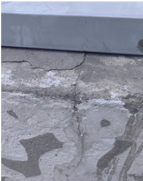
伸缩缝出现裂缝
