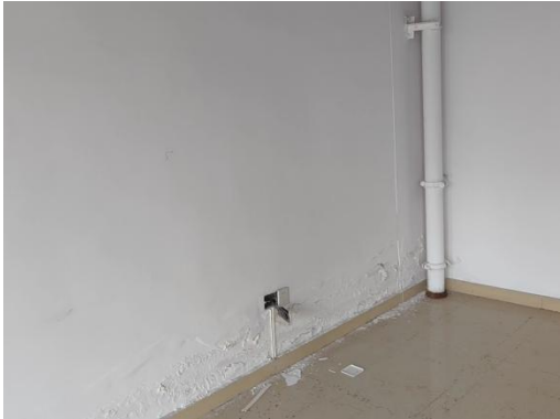
南侧房间墙角泡水
